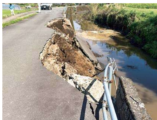
上井手左岸崩壊（大津町吹田）
